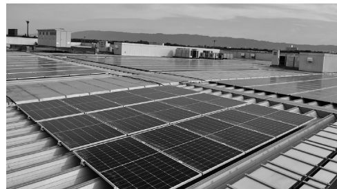
イオン小郡店の太陽光パネル
